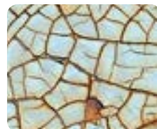
Челична конструкција со испукана боја и видлива корозија
